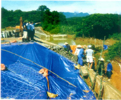
Đoàn công tác đã kiểm tra việc khắc phục sự cố sạt lở chân của xả tràn 1 hạng mục đang thi công của dự án nâng cấp, sửa chữa Hồ Ban thuộc xã Mân Đức, huyện Tân Lạc
