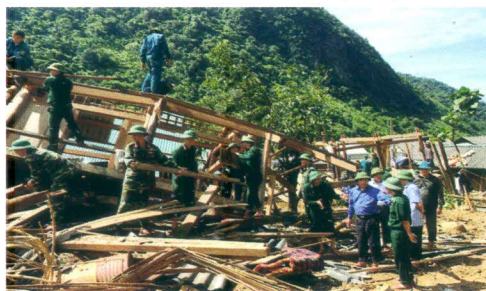
Đoàn công tác đi kiểm tra khắc phục hậu quả sau mưa lũ tại bản Poong, xã Tam Chung (H.Mường Lát), Thanh Hoá
