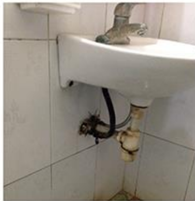
Bồn, đường ống nước, nền nhà bị ố vàng
