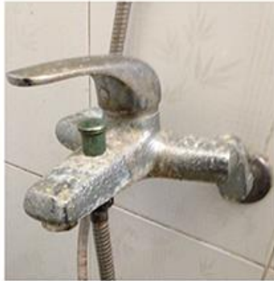
Vòi nước bị hoen rỉ, xỉn màu
